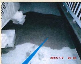
室内機排水垂れ流し
