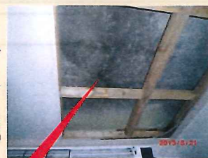
室内天井からの漏水状況
